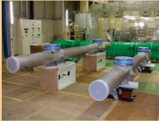
GHe return pipes
