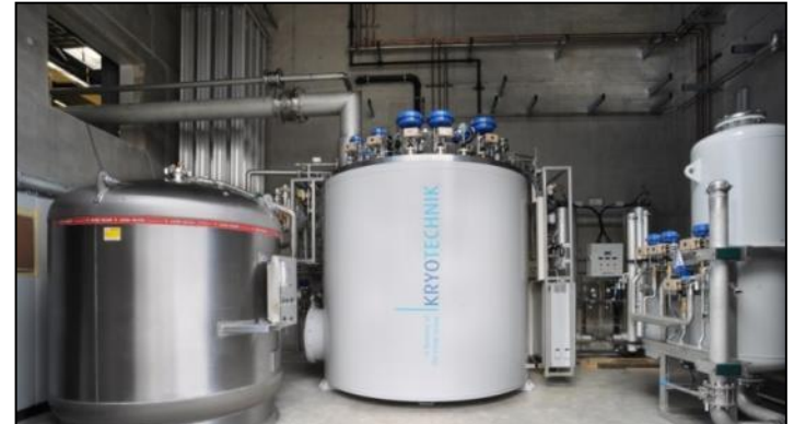
1.5 kW@4 K cold box
