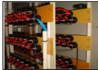
Rectifier Bank Assembly
